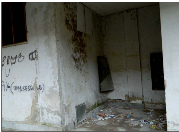
Rione Parco, abbandono e degrado
